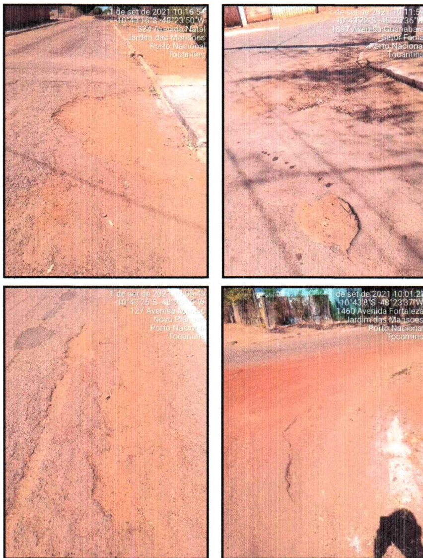
Figura 01 a 62: Capa Asfáltica Danificada. (Fonte: Autoria Própria).
